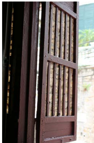
Figura 6.5.9: As janelas com lâminas de madrepérola do edifício na Rua Central n.º 47.
