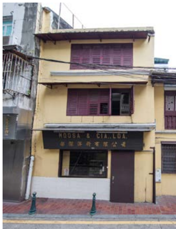
Figura 6.5.6: Estado de conservação actual do edifício na Rua Central n.º 45.
