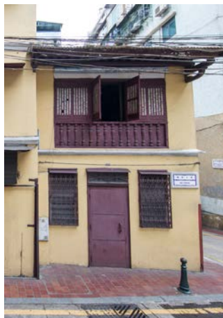
Figura 6.5.7: Estado de conservação actual do edifício na Rua Central n.º 47.
